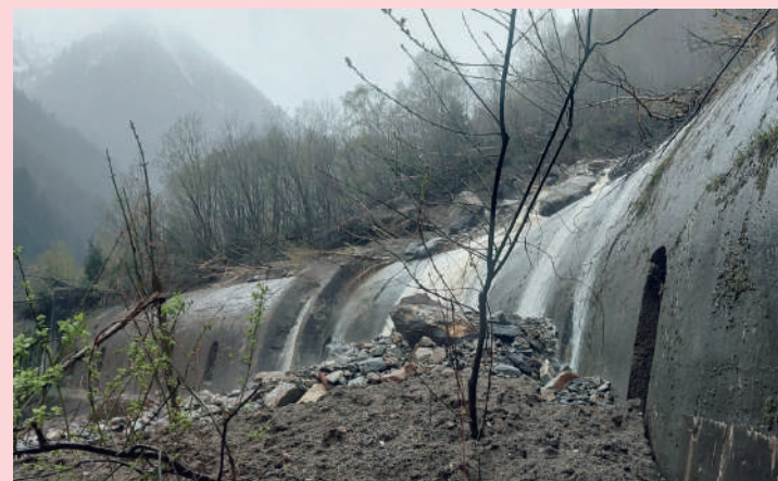
La frana alla galleria di Pestarena
